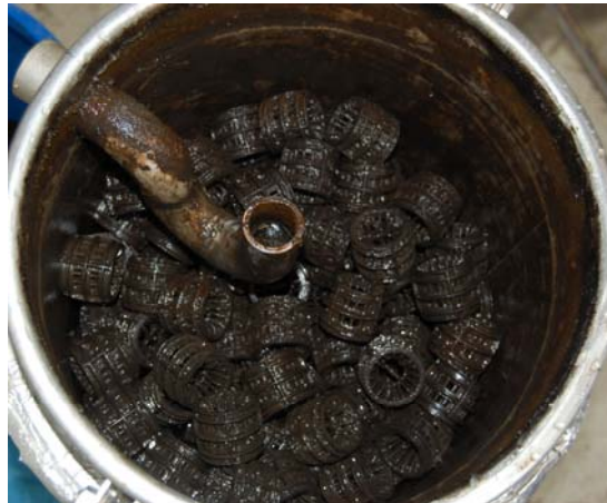
Abbildung 3: Bioflow Füllkörperschüttung im Methanreaktor und Siphon als gasdichter Flüssigkeitsüberlauf in das Absetzbecken
