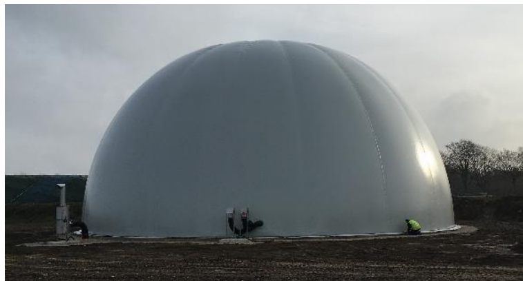
Abbildung 8 Aufgebauter externer Gasspeicher (Baur Folien GmbH)
