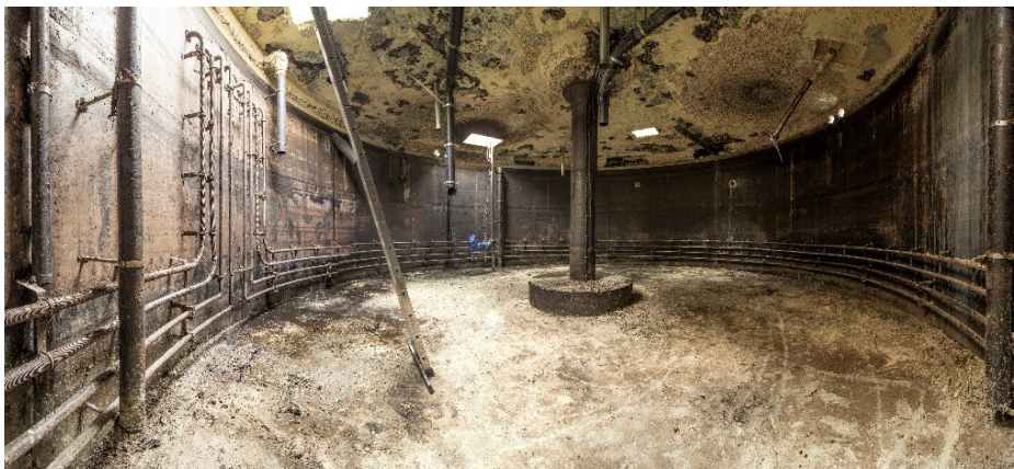
Umbaumaßnahmen im Fermenter der Forschungsbiogasanlage für die sensorgestützte Erkennung des Rührbedarfs (2021, Universität Hohenheim)
