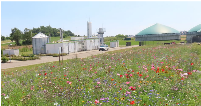
Biomethan-Aufbereitungsanlage (Erdgas Südwest)
