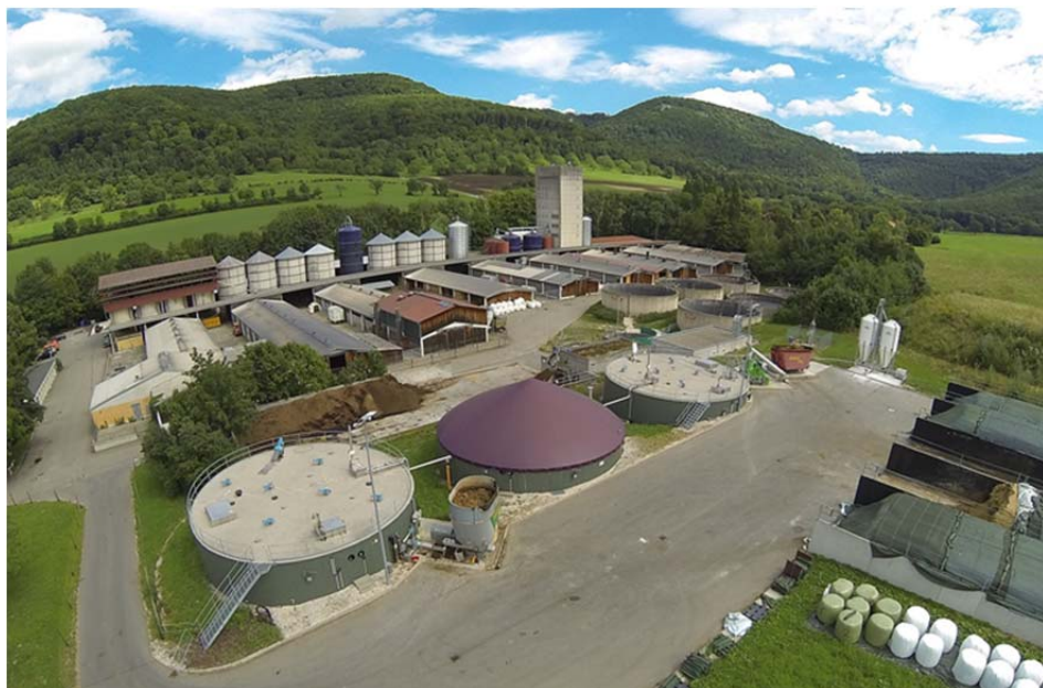
Forschungsbiogasanlage im Praxismaßstab am Unterer Lindenhof mit Nachgärer (Mitte, integrierter Folienspeicher) und zwei identischen Fermentern (Betondach mit Probenahmestellen)
