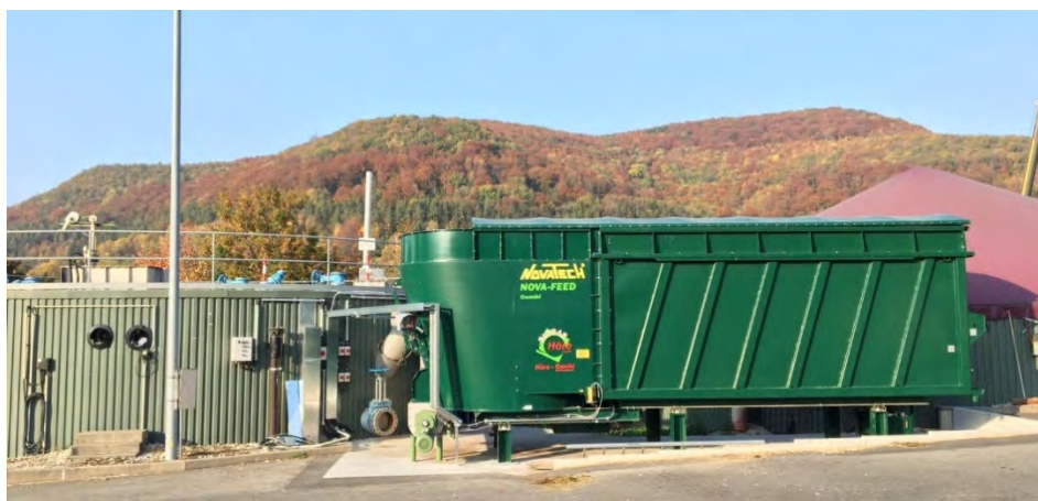
Der neue Feststoffdosierer am Fermenter 2 der Forschungsbiogasanlage (Kress, 2018)
