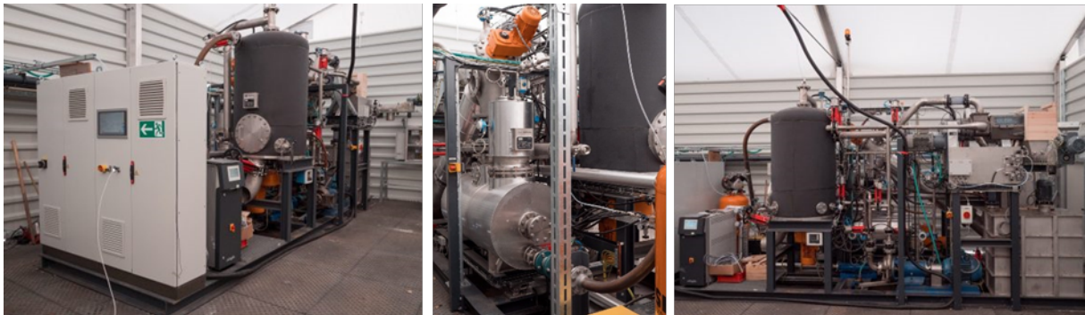
Abbildung 50: Schaltschrank der TDH (links), Hydrolysereaktor 400 l (mitte), Expansionsstank 200 l und Pulper, sowie Entstipper (rechts)
