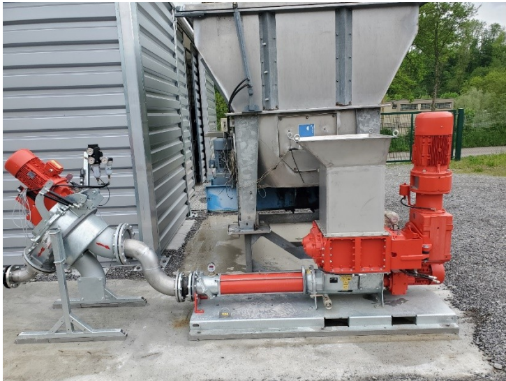
Abbildung 47: Zerkleinerungseinheit außerhalb der Halle
