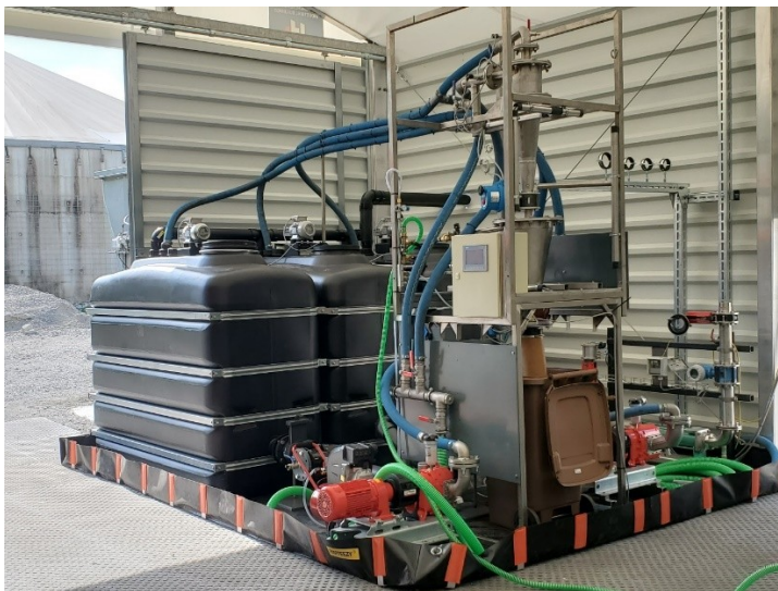
Abbildung 48: Aufbereitungsaggregate innerhalb der Halle
